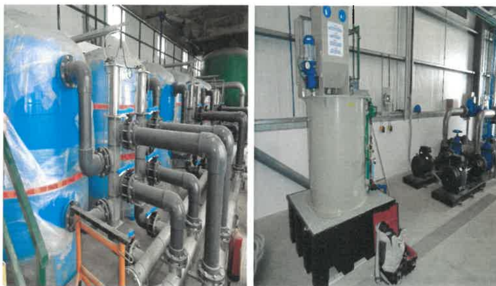
ETA de Bastelos
