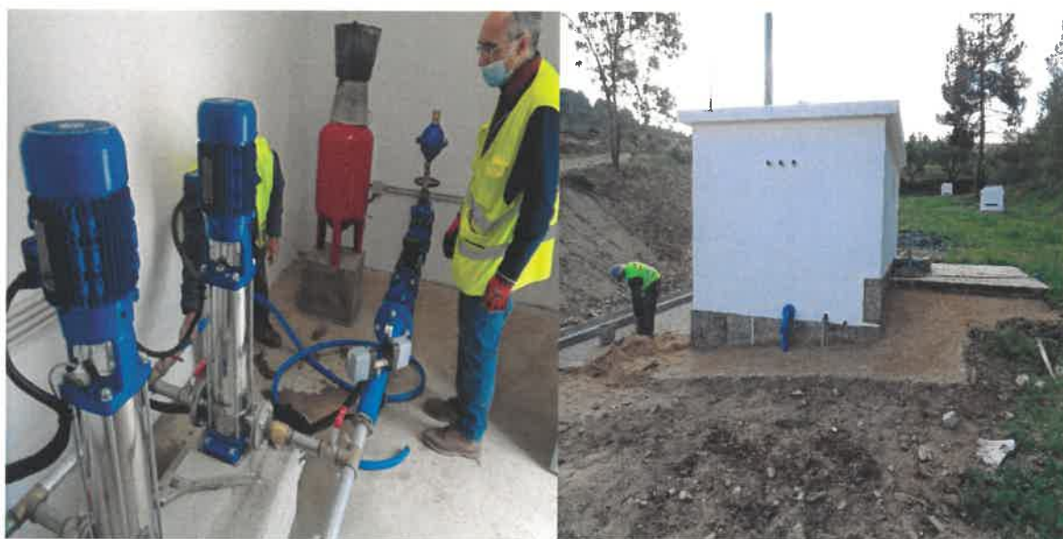
Figura 4 - Adutora entre a Maneta e o Reservatório do Penedo
