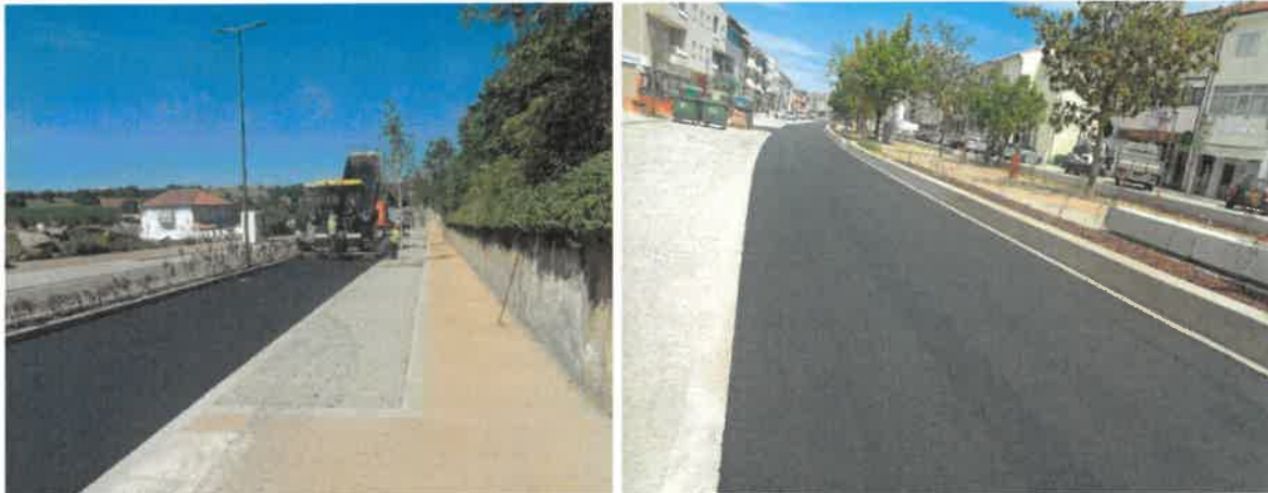
Requalificação da Av. do Sabor entre a Rotunda do Bombeiro e a Rotunda do Cogumelo
